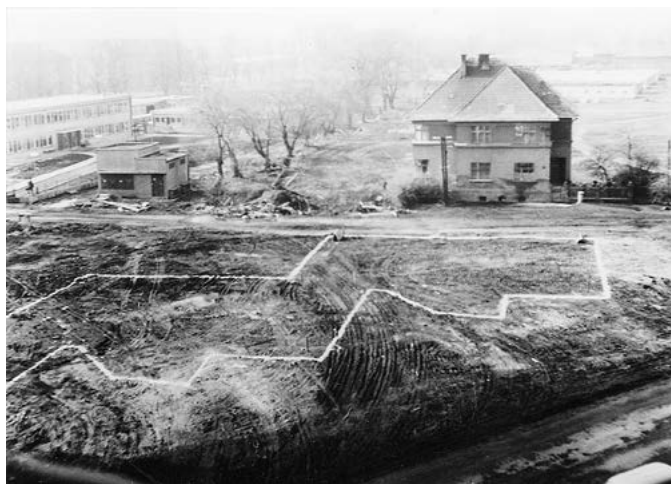
Prostor vybourané ulice Klicperova a U Sedmi zlodjů (ČS. Legii) s přípravou na stavbu harmoniky. Foto Pavel Polák, 1966
